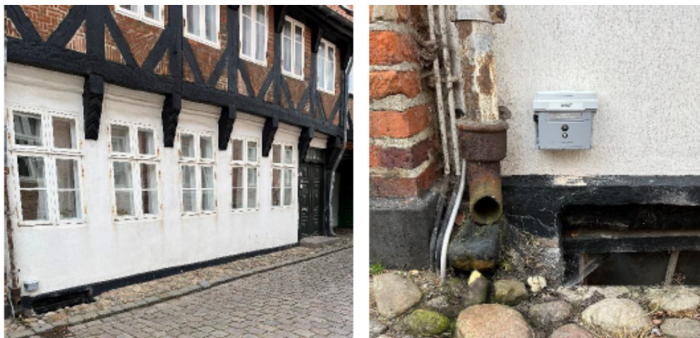
Figur 18. Eksempel på måleudstyr opsat på sokkel.
